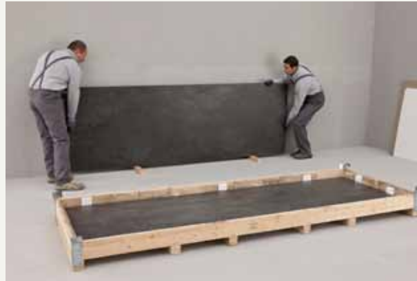
fig.7 / осторожно установите плиту на ее длинную сторону, слегка наклонив ее и предварительно подложив под нее мягкий материал или надлежащим образом расставленные деревянные рейки.
